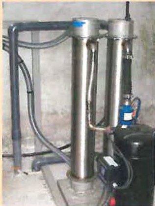
Pompe à chaleur
