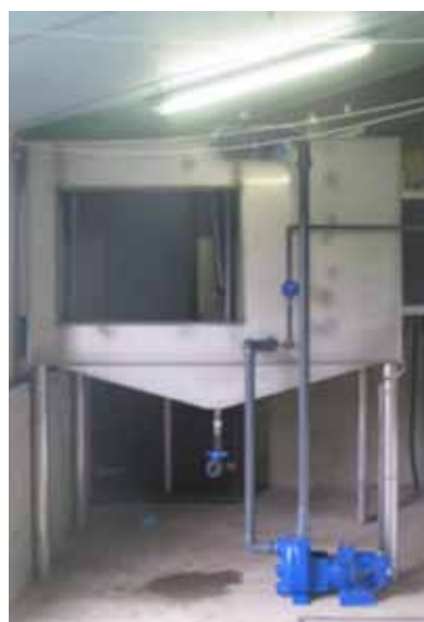
Illustration d'un des laveurs d'air installé sur une salle d'engraissement
