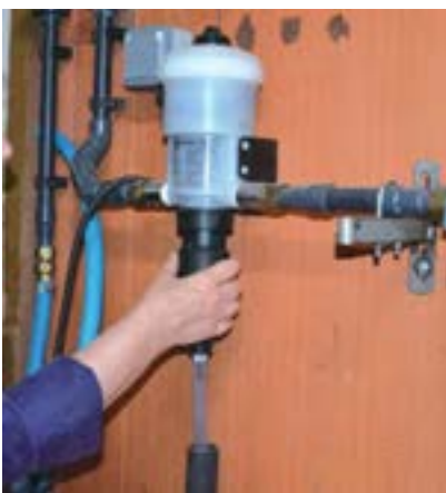
Vérification de la précision du dosage par la pompe
