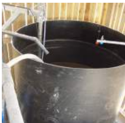
La cuve de mélange est équipée d'une sonde de niveau permettant de réguler les flux d'effluent.
