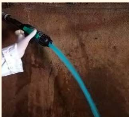
Evacuation du biofilm par une vanne de purge lors du protocole de décapage
