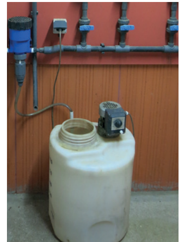
Bac de solution mère d'une pompe doseuse
