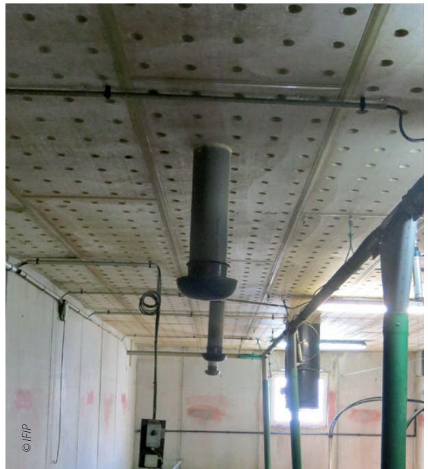
Exemples de double entrée d'air des salles : plafond perforé pour les faibles débits et volets motorisés ou champignons pour les débits plus importants.
