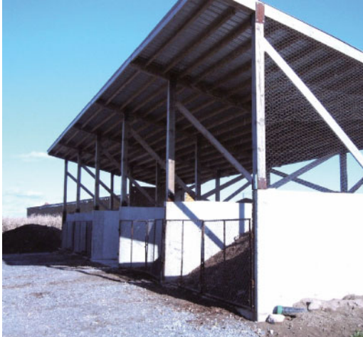
Vue d'ensemble des 5 silos de compostage (pour 200 truies NE)
