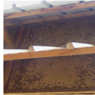
Entrée d'air en pignon colmatée à plus de 50 %.
